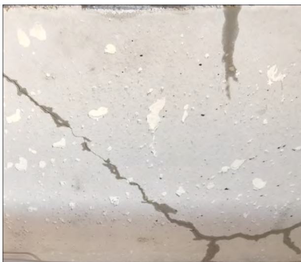
Hormigón con micro-fisuras que provocan pérdidas de agua de nuestra piscina o depósito.
