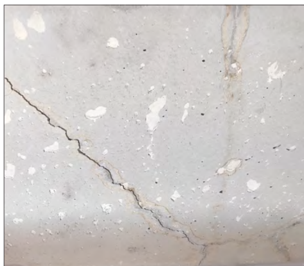
Una vez finalizado el proceso con NO-CRACKS se han formado micro-cristales en el interior de la piscina que atajan la pérdida de agua.
